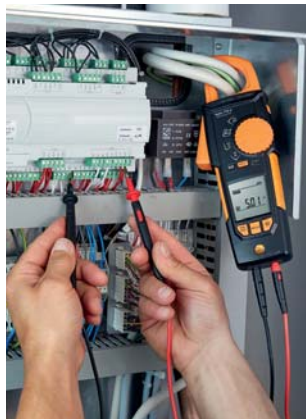
배전함의 전류 측정
