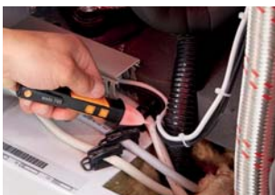
압축기의 전압 공급 점검
