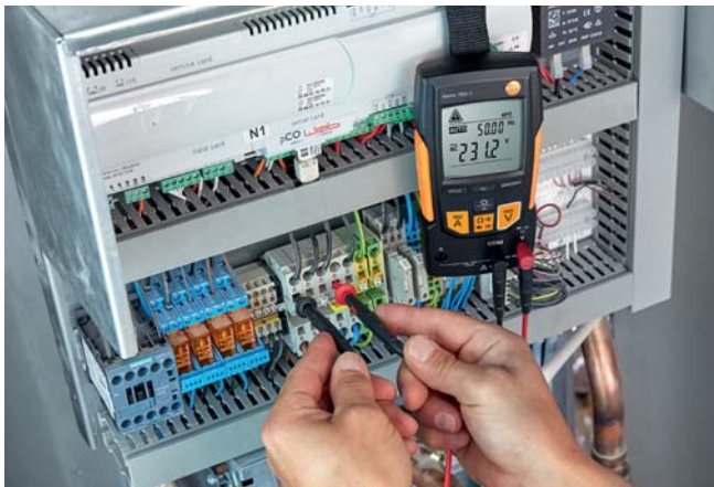
배전함의 전압 측정
