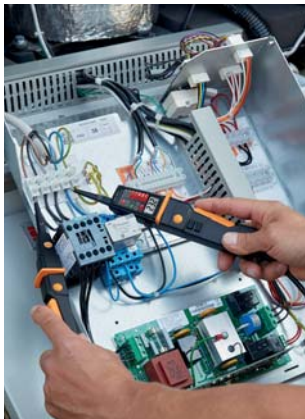
압축기의 전압 측정
