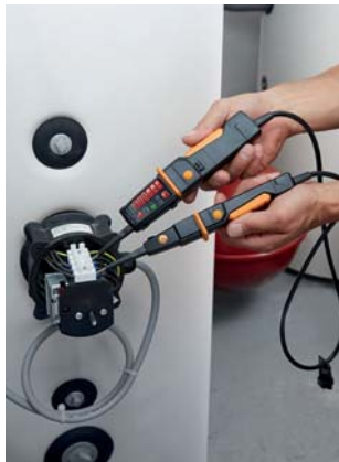
보일러의 전압 측정
