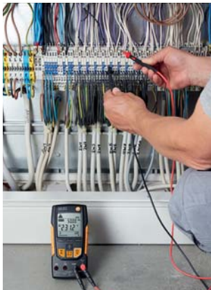
분전함의 전압 점검
